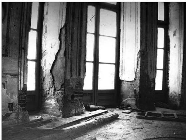
Круглый зал павильона Кательной горки. Юго-западная часть интерьера. Состояние до реставрации 1953 ГМЗ «Петергоф»
